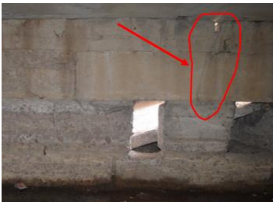
Рисунок 23 – Обнаруженные трещины в фундаменте, фото 2
