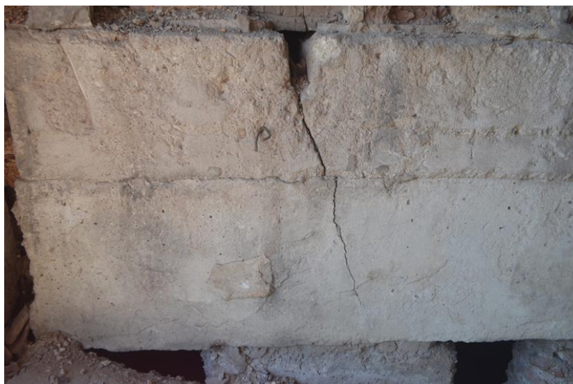
Рисунок 22 – Обнаруженные трещины в фундаменте, фото 1
