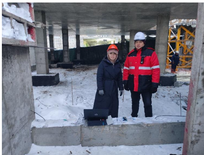
Рисунок 124 – Контрольные измерения технического состояния СЖК
