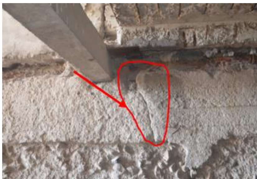
Рисунок 24 – Обнаруженные трещины в фундаменте, фото 3
